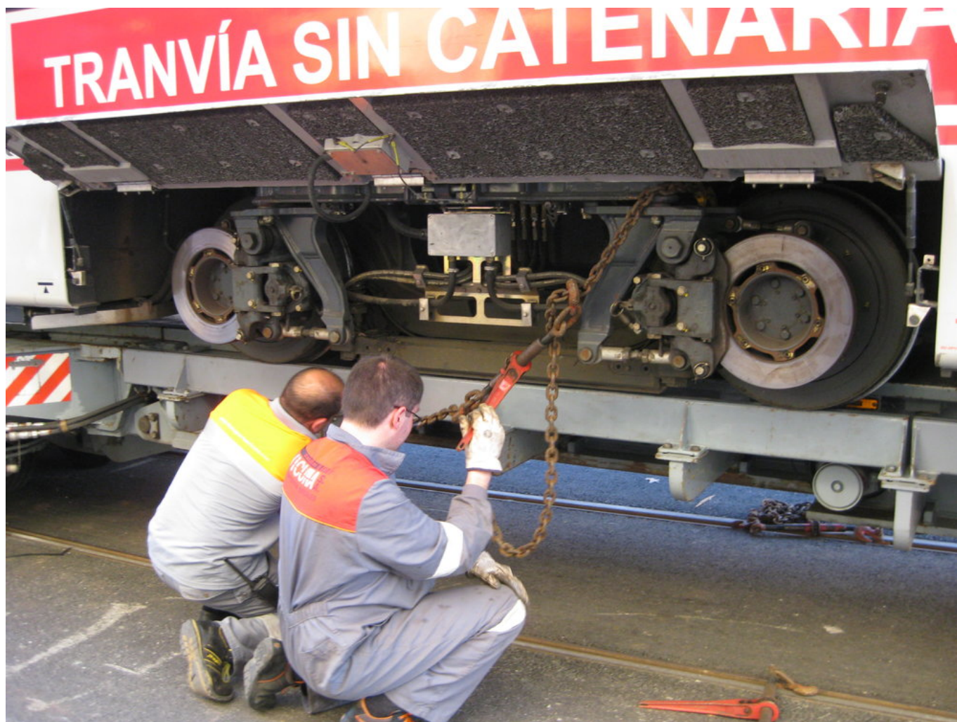
Stahování tramvaje Urbos ev. č. 105 po zkouškách se superkondenzátory. (foto: Miguel Cano López-Luzzatti)
