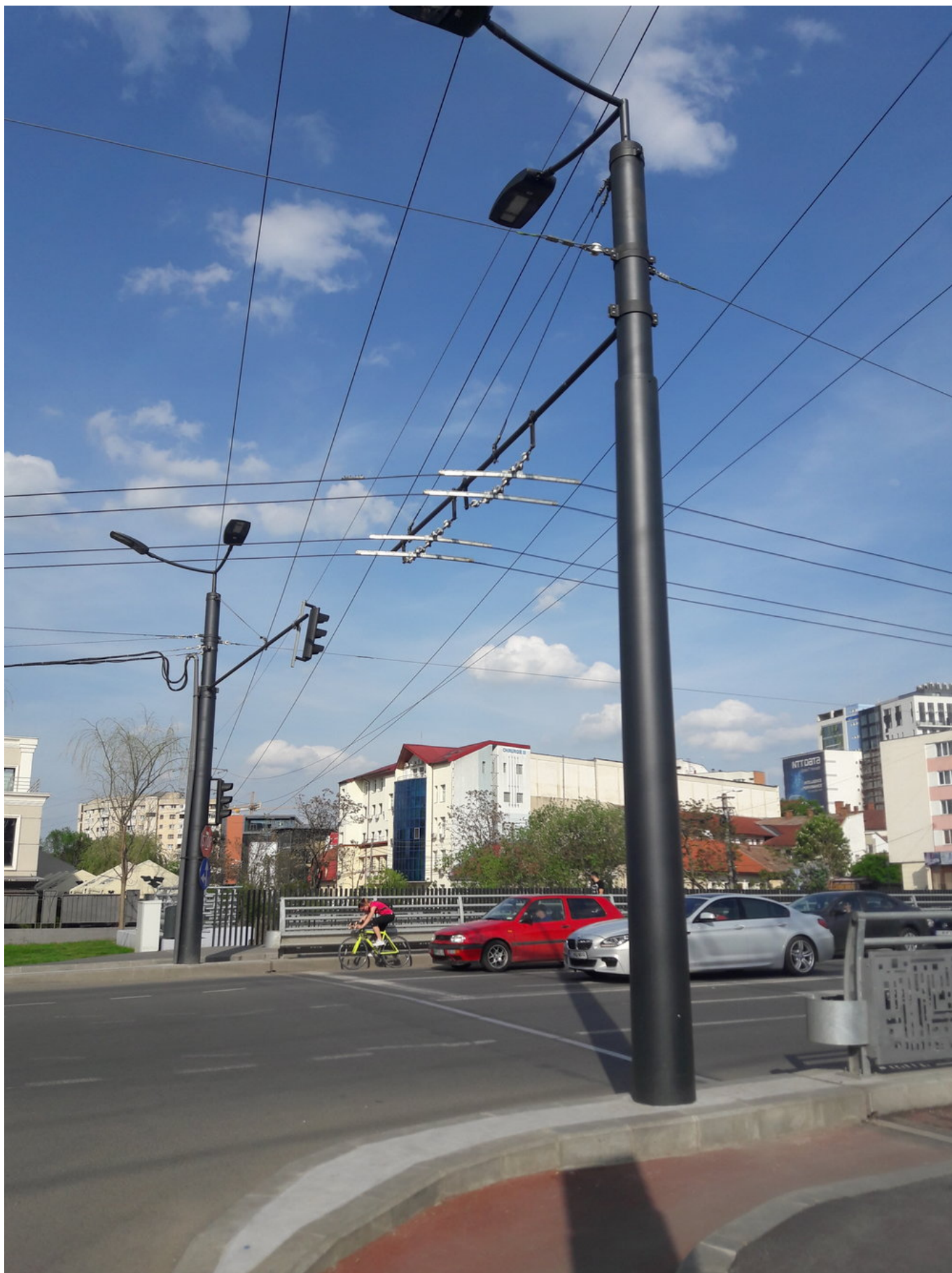
Trolejbusová síť byla podstatně rekonstruována.
