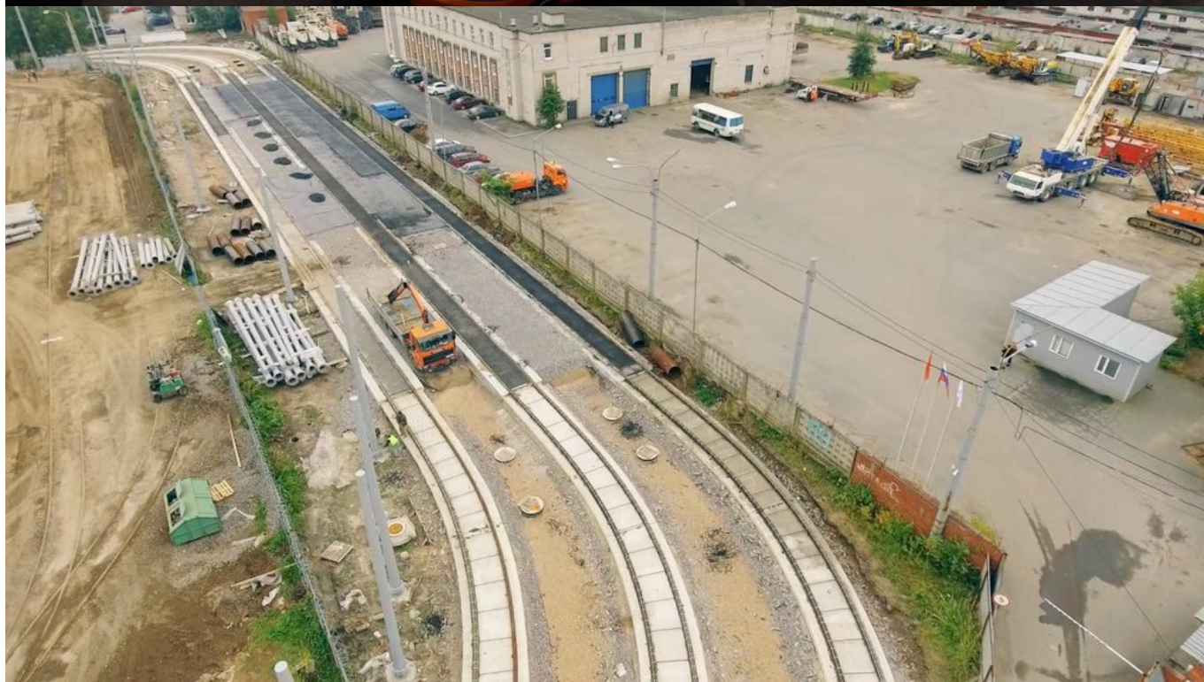
Pohled na areál u ulice Chasanskoj loni během stavby. (foto: Čížik / TKK)
