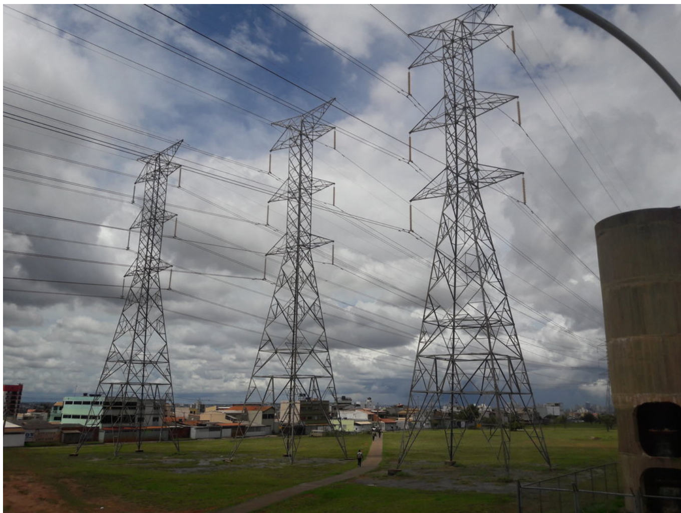
Dráty vysokého napětí z rozvodny Furnas.
