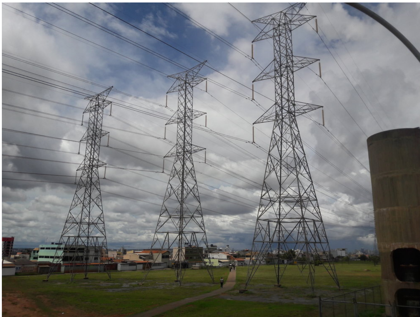
Dráty vysokého napětí z rozvodny Furnas.
