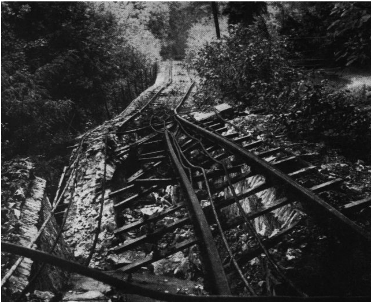
Sesuvem poškozené těleso lanové dráhy v roce 1967. (zdroj: archiv DPP)
