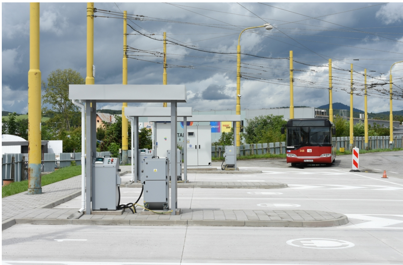
Nabíjecí místa vybudovaná v areálu vozovny v Prešově v létě 2023. (foto: Libor Hinčica)
