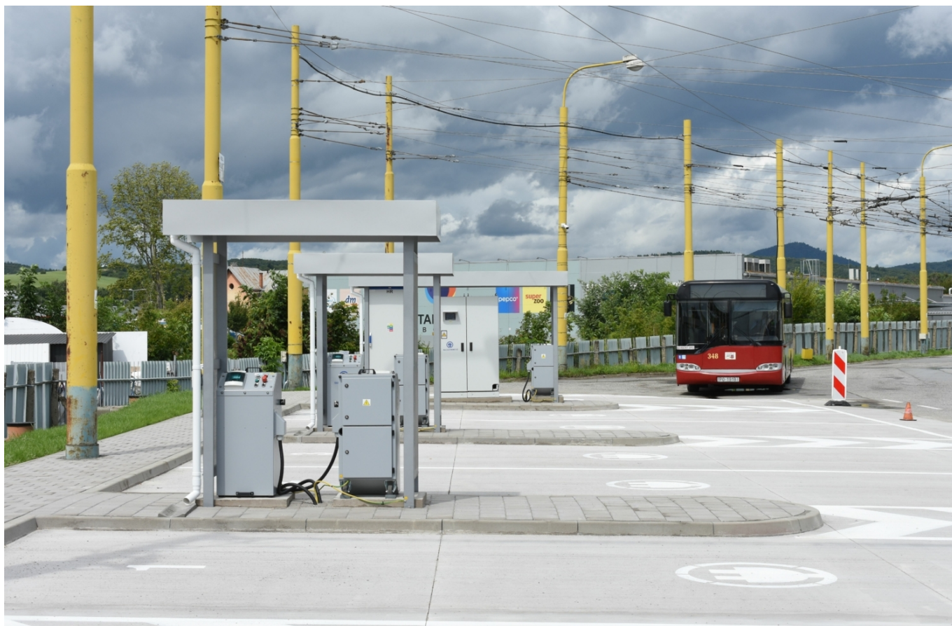
Nabíjecí místa vybudovaná v areálu vozovny v Prešově v létě 2023. (foto: Libor Hinčica)
