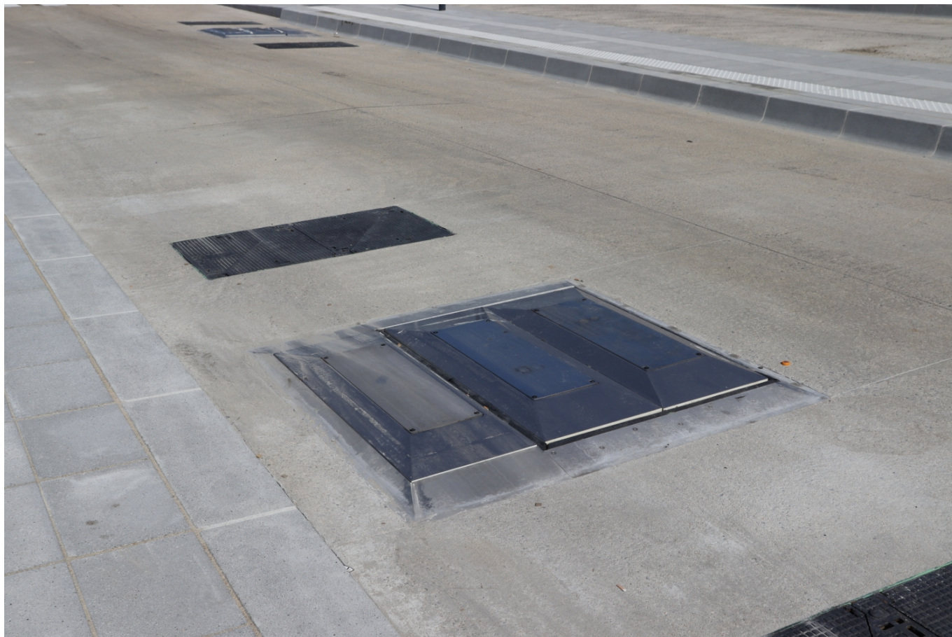
Detail nabíjecího místa (panelů pro spojení s pantografem) v zastávce budoucí linky Tzen 4. (foto: Ing. Vojtěch Kudláč)
