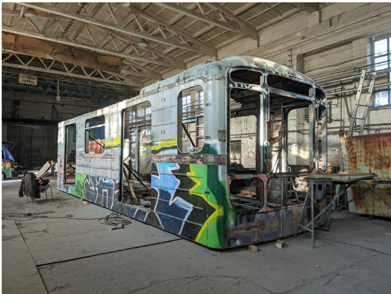
Skelet po rozříznutí a umístění na nově svařený podlahový rám. (foto: Kryštof Šenkýř)
