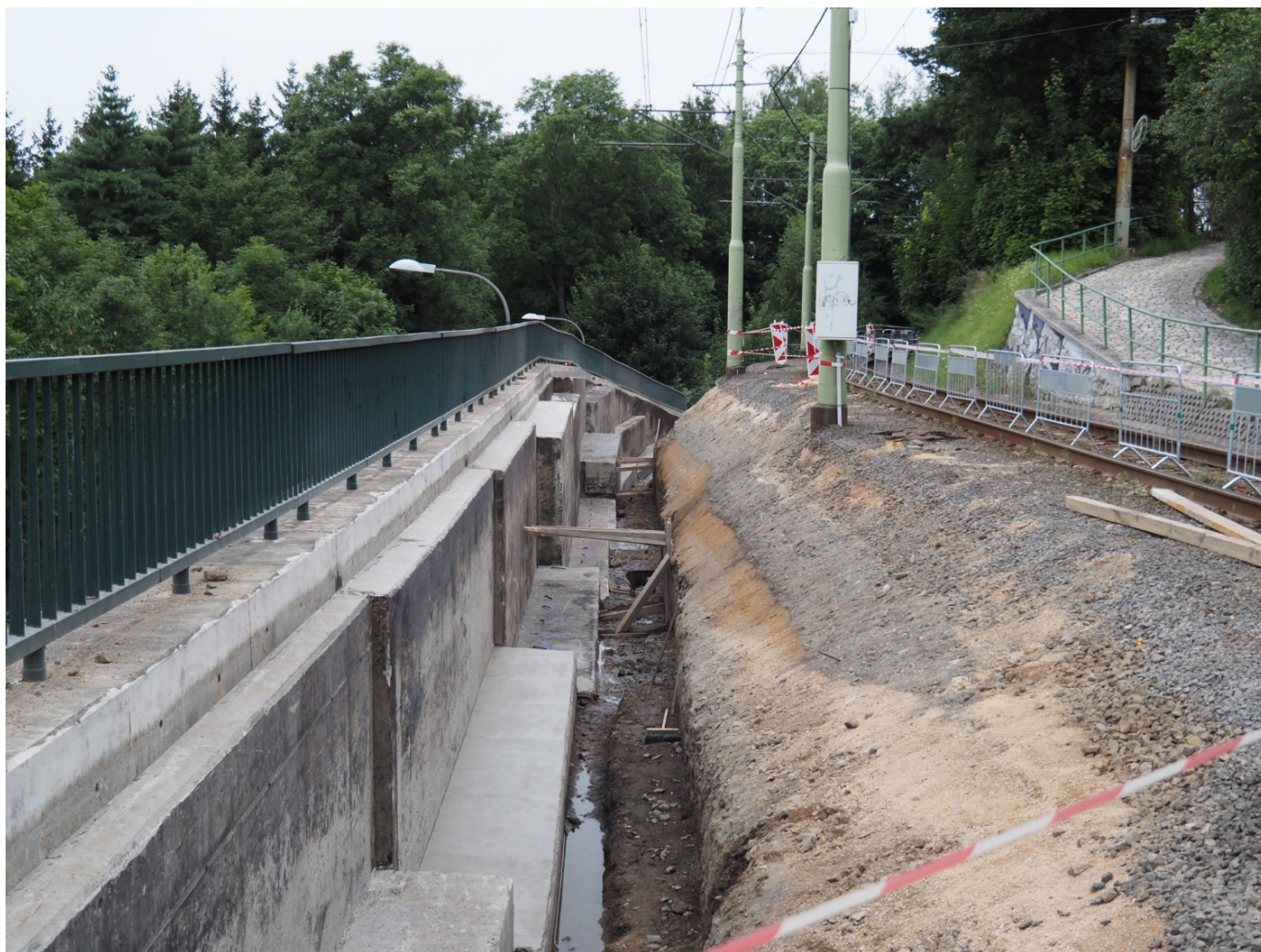
Opravu prodělala i vnitřní strana opěrné stěny pod Novou Rudou, při které muselo být odstraněno těleso přilehlé koleje. (19. srpna 2021; foto: Zdeněk Mazánek)
