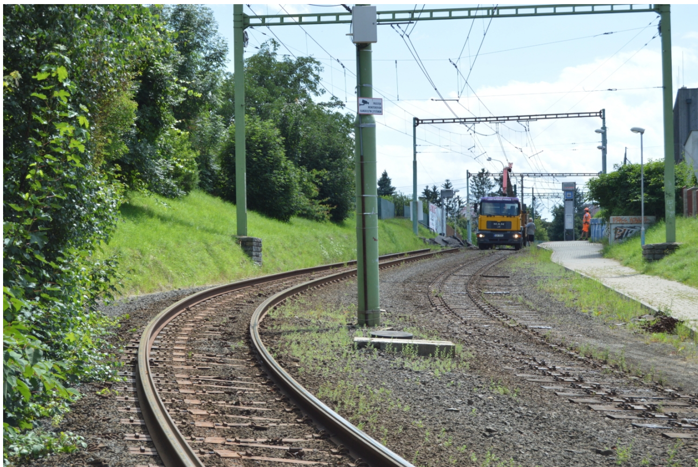
Rekonstrukce kolejiště na Nové Rudě. Vlevo došlo pouze k posunutí kolejnice, napravo ke kompletní demontáži kolejnic a náhradě původních dřevěných pražců za Y-pražce. (29. července 2021; foto: Zdeněk Mazánek)
