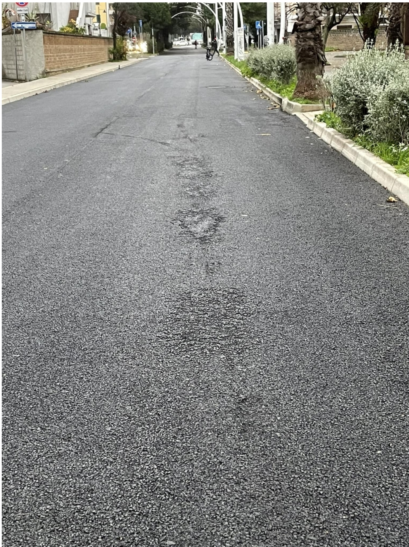
Nedávno položený nový asfalt vykazuje i bez provozu trolejbusů či jiných silničních vozidel po pár týdnech své existence tuto „kvalitu“. (foto: Comitato Strada Parco Bene Comune)
