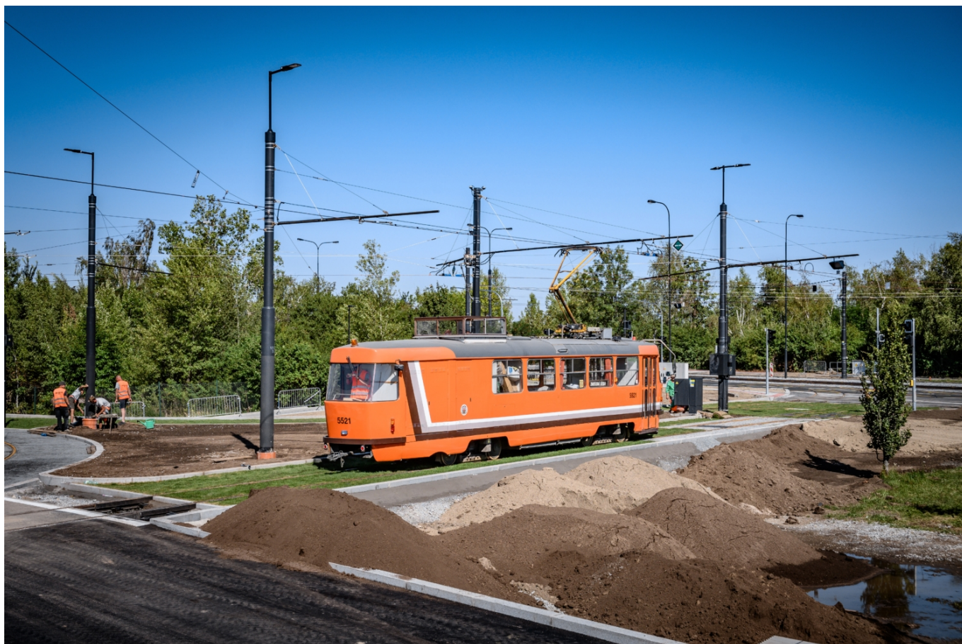
Příprava zelených povrchů se odehrávala tradičně na konci stavby. (foto: Honza Tran)
