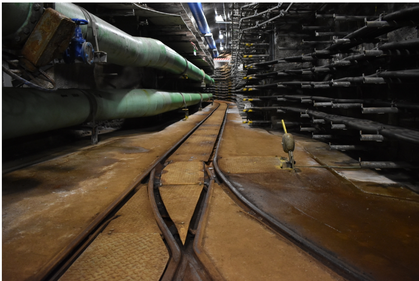
Pohled do útrob kolektoru v místě odbočky z hlavní tratě k I. P. Pavlova. (foto: Libor Hinčica)
