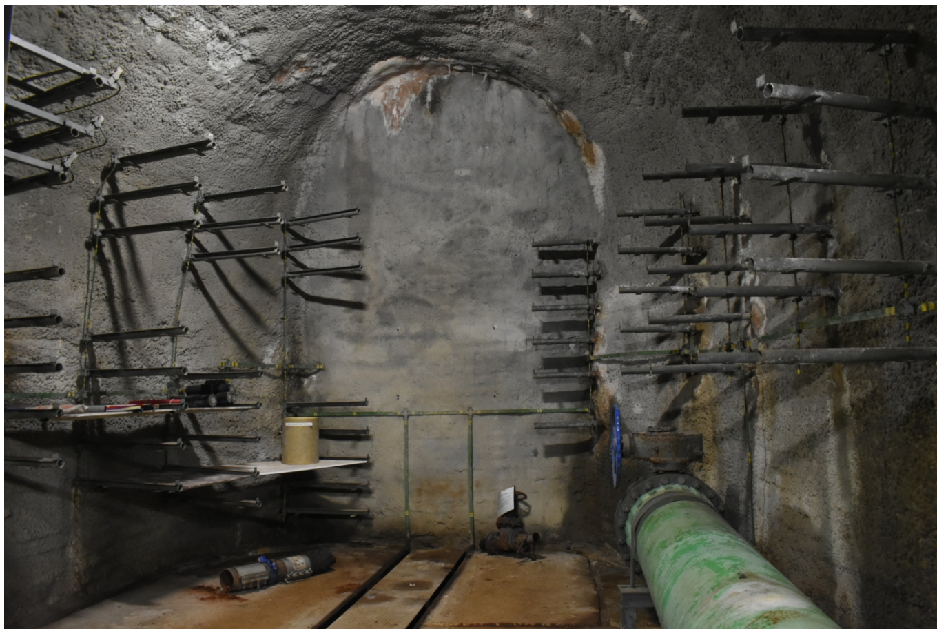
Příprava na prodloužení tratě do kolektoru pod Hlávkovým mostem. (foto: Libor Hinčica)
