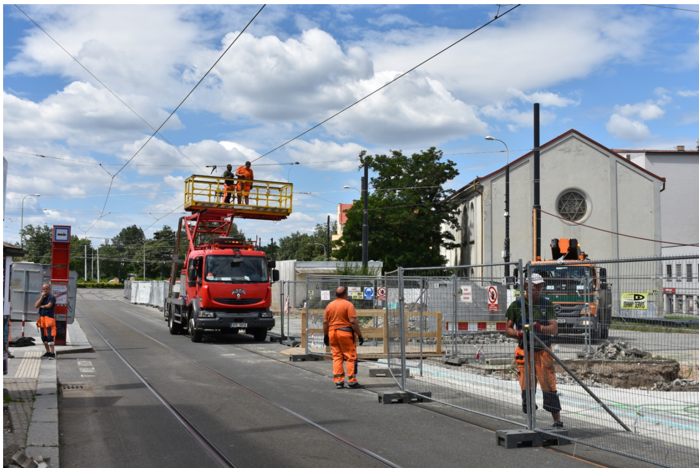
Výstavba infrastruktury v sobotu dne 16. 7. 2022 u Palmovky. napravo je k vidění budova nové libeňské synagogy, jejíž základní stavební kámen byl položen v roce 1846. (foto: Libor Hinčica)
